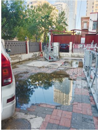
三义大厦2号楼后方污水井跑冒。
