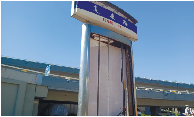
“复康路”道路指示牌出现明显损坏。
