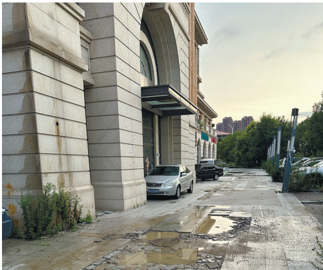
秀竹苑小区外围底商门前步行道损毁严重。
