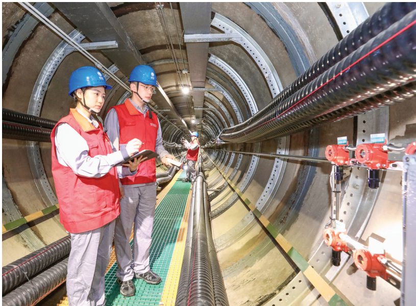
连日来，国网天津电缆公司工作人员在220千伏绿水园电缆隧道开展秋检特巡，利用红外测温等手段排查隐患，确保电网主动脉安全运行。
