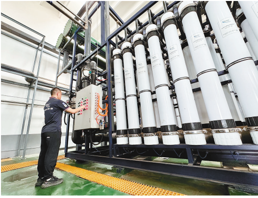
工作人员对超滤单元例行巡检。
