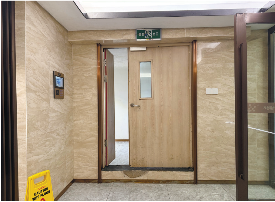
雍祥府小区高层楼栋电梯间通往地下一层停车库处设有超15厘米高的门槛。
