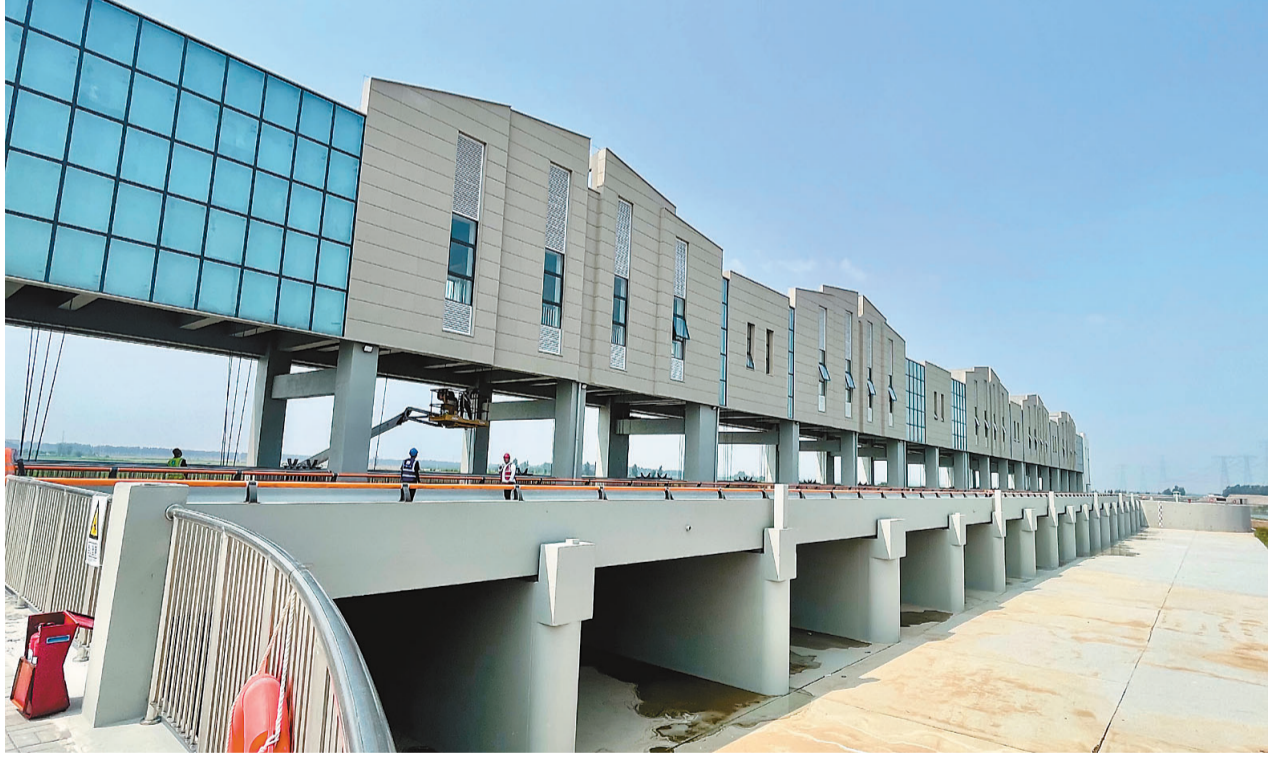
位于静海区的大清河右堤清南分洪闸建设项目,主体工程目前已全部完工,全线具备挡水条件。 记者 张磊 摄
