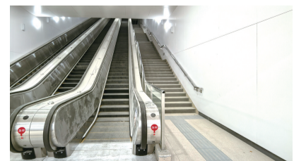
站,待8号线开通后,将成为地铁1号线、5号线、8号线三线换乘枢纽,交通区位优势突出。本次安装的超大规格扶
