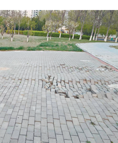
钻石公园道路坑洼。
