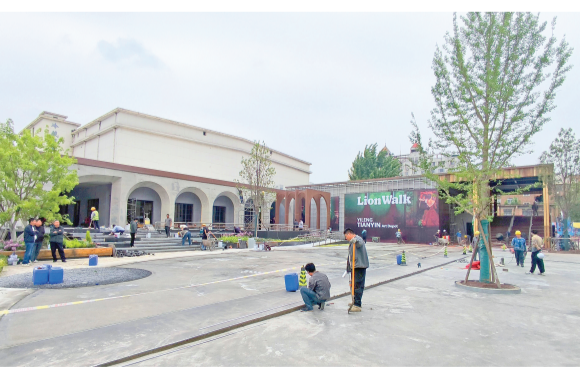
日前，河东区一冷·天音城市更新项目初现雏形。该项目盘活第一冷冻厂闲置厂区，打造音乐时尚创意街区。
