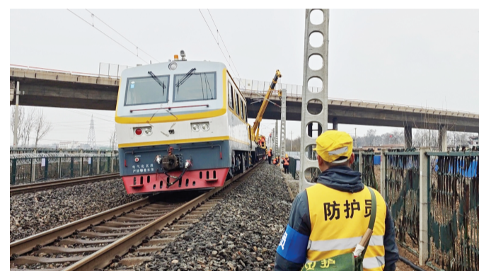
日前,津沧高速改扩建完成“四电”拆改,为工程后续推进打通了关键堵点。 记者 张磊 摄
