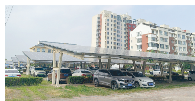
充电站内,居民正在给车辆充电。
