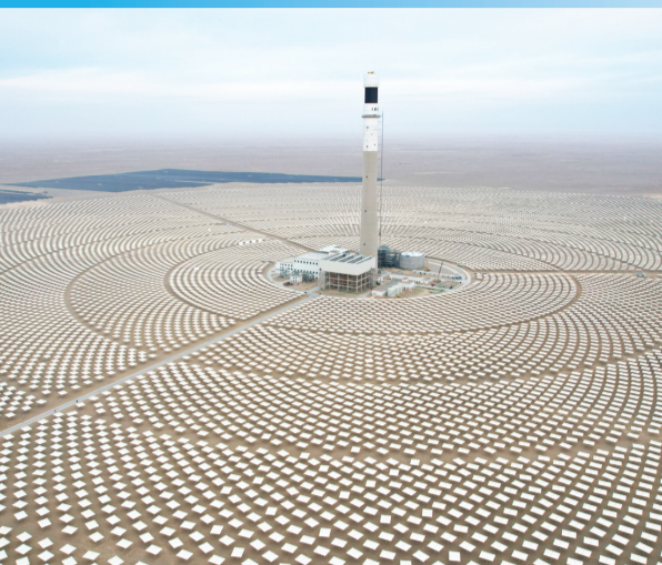
甘肃省酒泉市金塔县白水泉光电产业园内,建设中的金塔中光太阳能“光热+光伏”试点项目。
