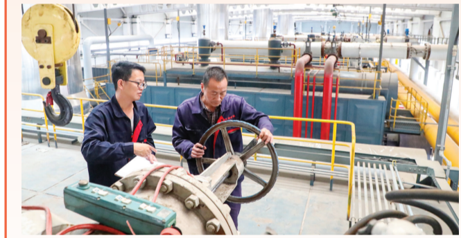
国丰供热有限公司万新村供热站工作人员实时监控关键数据。 本报记者 周伟 通讯员 刘泽瑞 摄
