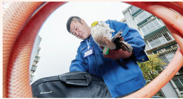
河北区天泰路供热站“管家”正在准备维修工具。 本报记者 吴迪 摄
