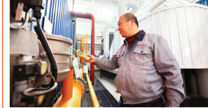
上图 南开区组建40人应急抢险队伍，配备供热管家100人、供热维修人员380人。图为供热工人在巡视检测供暖情况。 通讯员 石乔 刘峰 本报记者 胡凌云 摄
