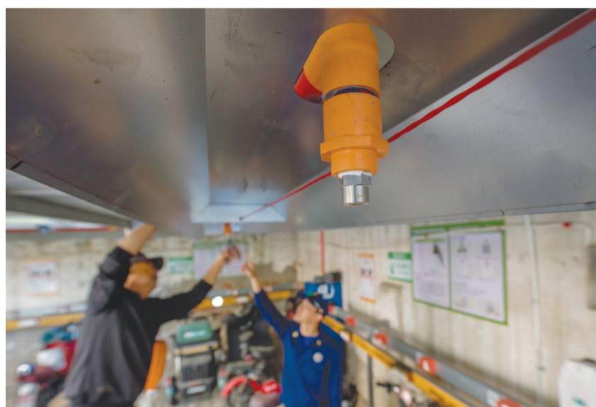
目前,部分小区在电动自行车充电车棚内加装了自动灭火设施,当出现火情时,该系统可通过高温感应启动自动喷淋,降低火灾蔓延速度,遏制火势发展。
