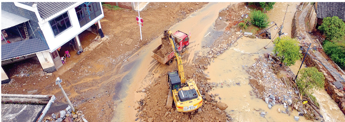
8月18日，在祁阳市潘市镇龙溪村，施工人员驾驶工程车辆清理石块、疏通道路(无人机照片)。
