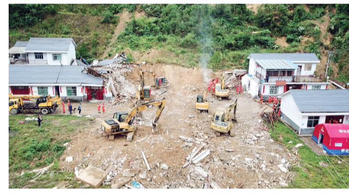
图为鱼市镇斗溪村龙塘组拍摄的山体滑坡现场。 新华社发
