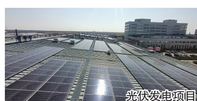
光伏发电项目
