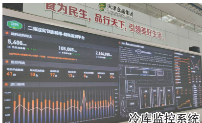
冷库监控系统
