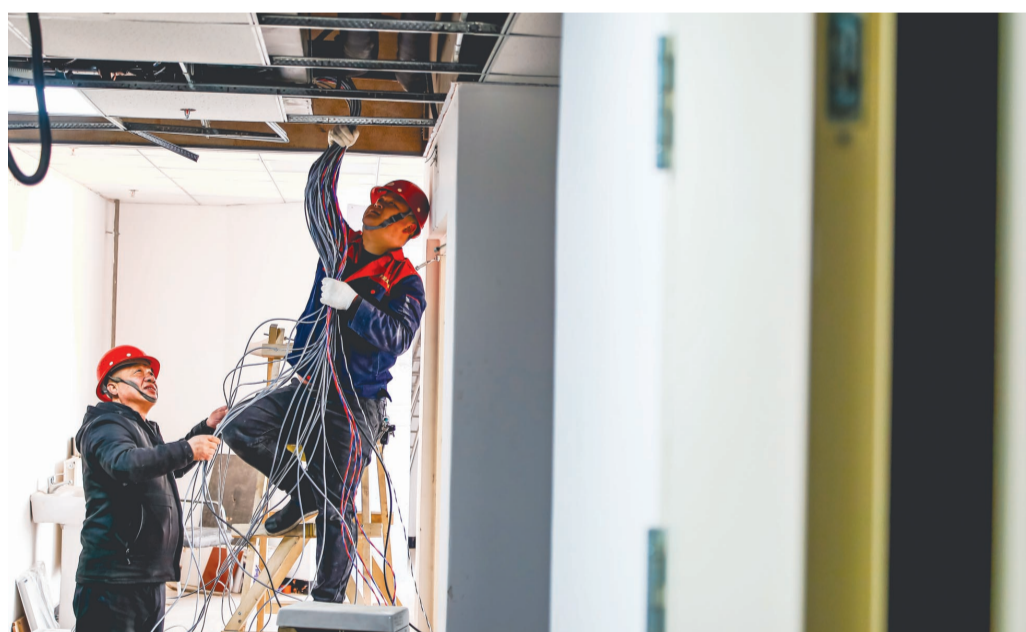
西青第一养老院项目建设已进入内部修缮阶段,预计今年7月交付使用。该养老院共设老人房60间,核定床位180张,设计了专业化护理分区,投用后可满足不同老人护理需求。
