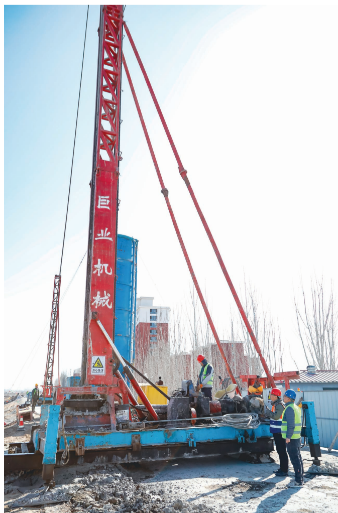
为了提升台头镇大清河北围埝抵御洪水能力,静海区水务局对台头北围埝加固施工,该工程预计6月完工。
