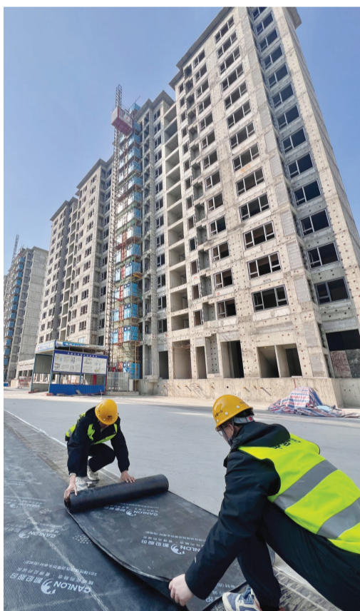
中国一冶天津公司施工人员正在武清区城区河东片区棚改工程项目现场铺设防水设施。这是武清区重点民生工程。预计今年10月份一期工程完工,项目建成后将解决当地1622户群众的居住问题,改善当地居民居住环境。
