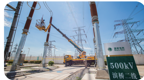
▲国网天津电力工作人员在滨海500千伏变电站内进行高压试验工作。
