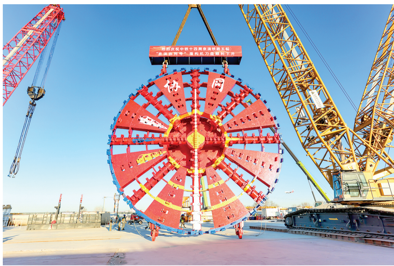
滨海新区中街十四号原京滨铁路五号“滨滨协同号”盾构机刀盘顺利下井
