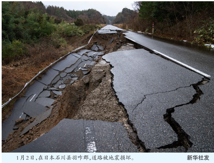
1月2日,在日本石川县羽咋郡,道路被地震损坏。
