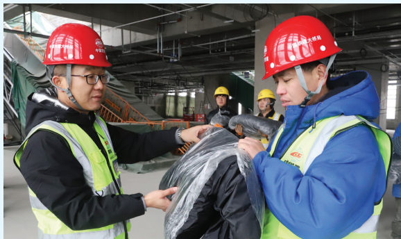
近日,中国铁建大桥局电气化公司工会人员来到津静市域铁路项目施工现场,为一线建设者送去防寒衣物。 本报记者 张磊 摄
