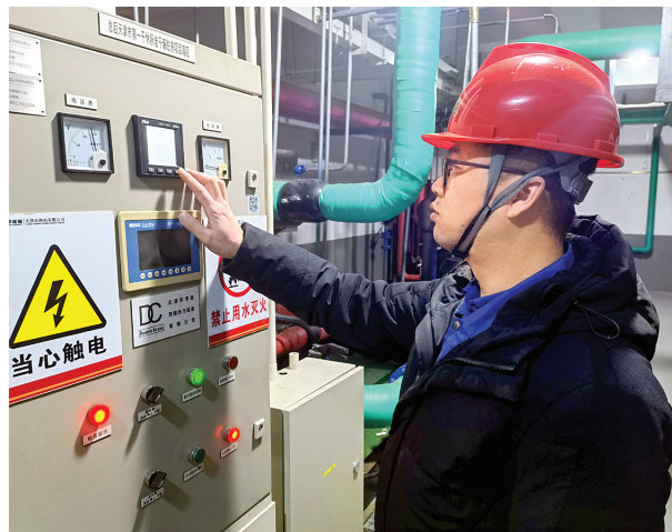
连日来,天津能源集团热电公司东北郊第二供热服务中心工作人员每天对热力站进行不间断巡查,确保居民家中供热达标。 本报记者 张磊 摄
