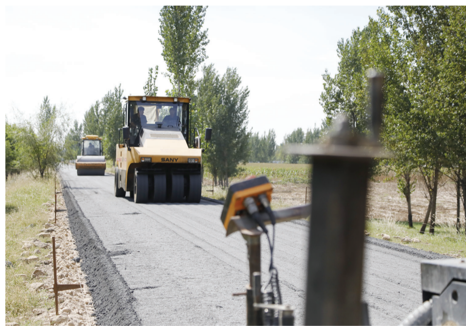
静海区台头镇对11条需要修复的道路路面开展抢修。图为工作人员使用压路机等机械设备对姜坝路进行修复。
