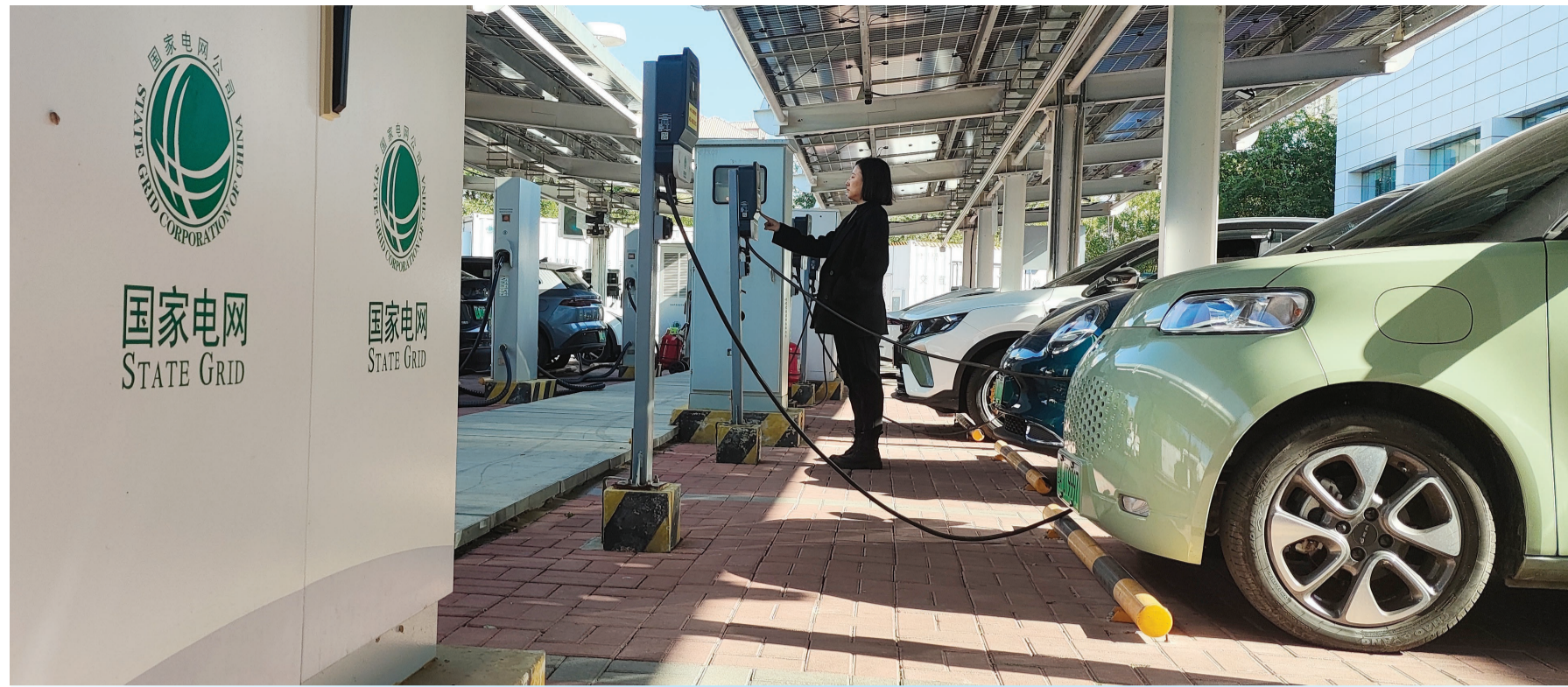
天津湖新能源综合服务中心充电站。
