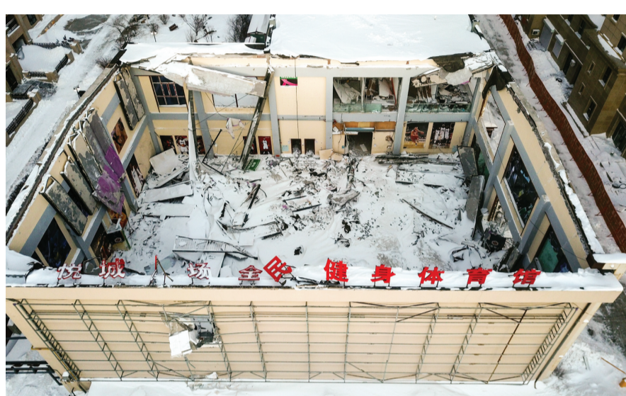
这是11月7日拍摄的发生屋顶坍塌事故的黑龙江省桦南县悦城体育俱乐部。
