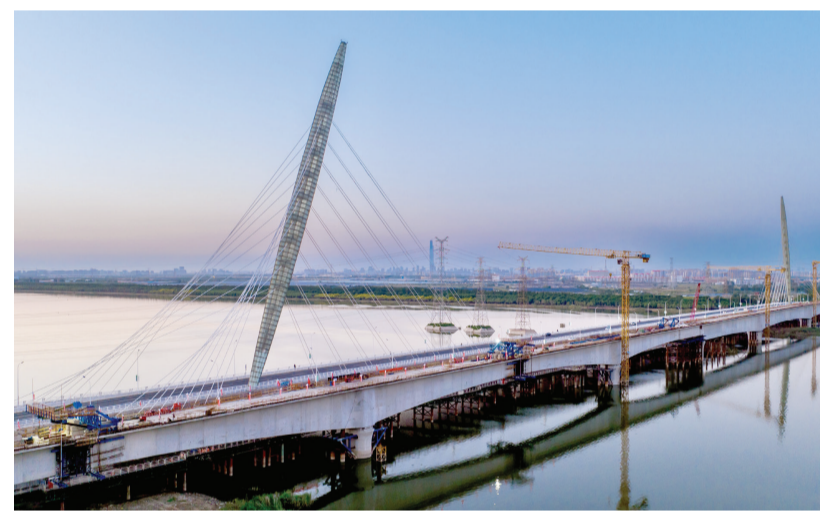
9月15日凌晨,我市在建最长水上桥梁——跨独流减河特大桥全桥合龙。 通讯员 任志伟 本报记者 张磊 摄
