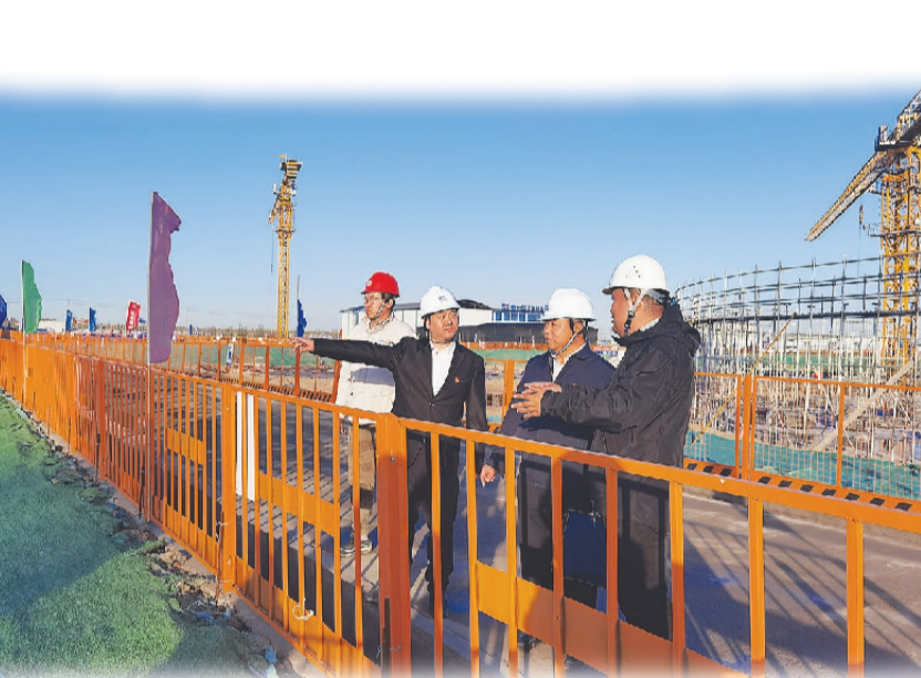
▲市纪委监委驻市水务局纪检监察组在位于东丽区登州路的中心城区水务工程建设项目现场开展监督检查。
