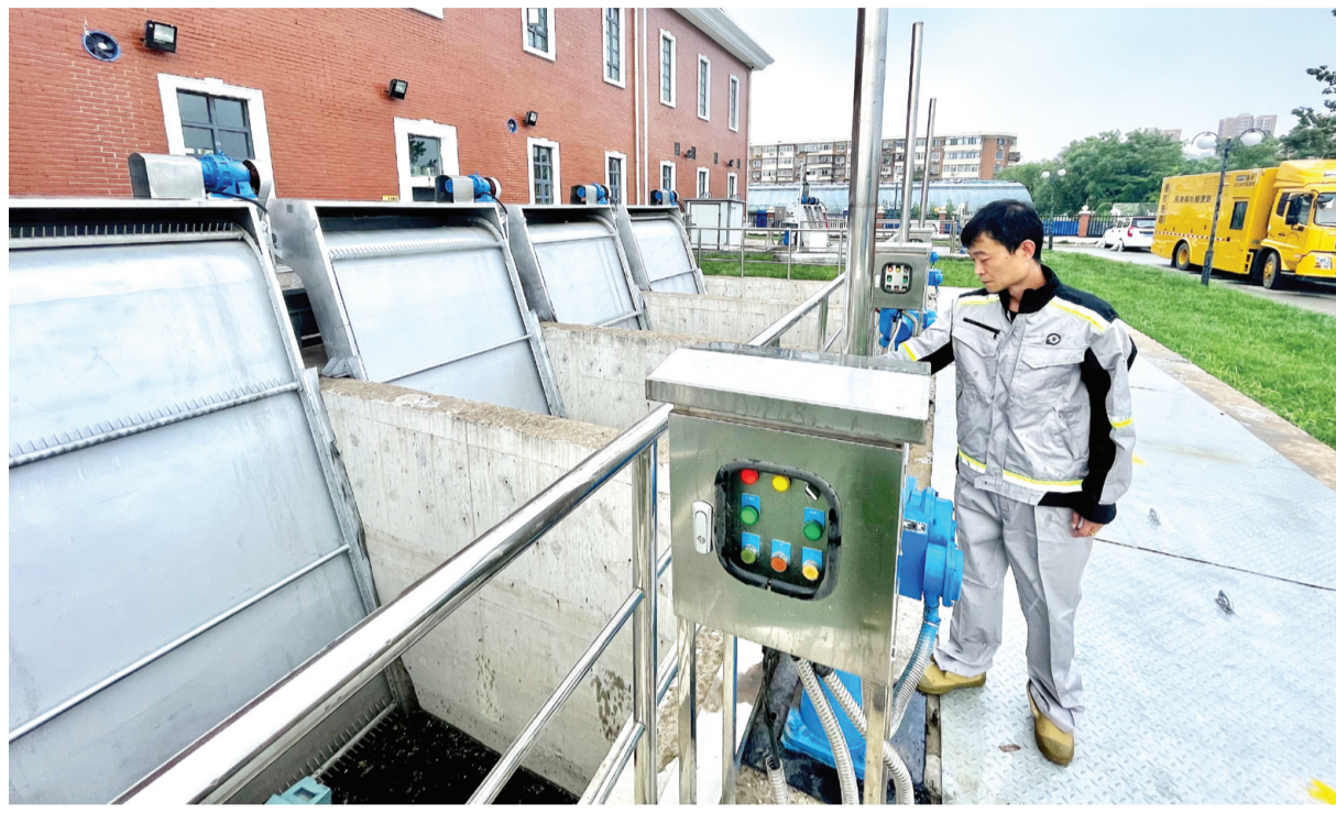
近日,西青区罗浮路雨污水合建泵站正式投入使用,泵站共配备潜水轴流泵6台,设计流量12立方米/秒。投入使用后,提升了中心城区雨水排放能力,解决了西青道(密云路—外环线)雨水排放问题,有效缓解了西青道、春畅里、秋英里等地区的雨后积水问题。 本报记者 张磊 摄
