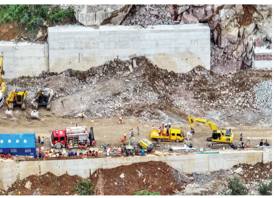
7月9日，救援人员在滑坡现场勘察。
