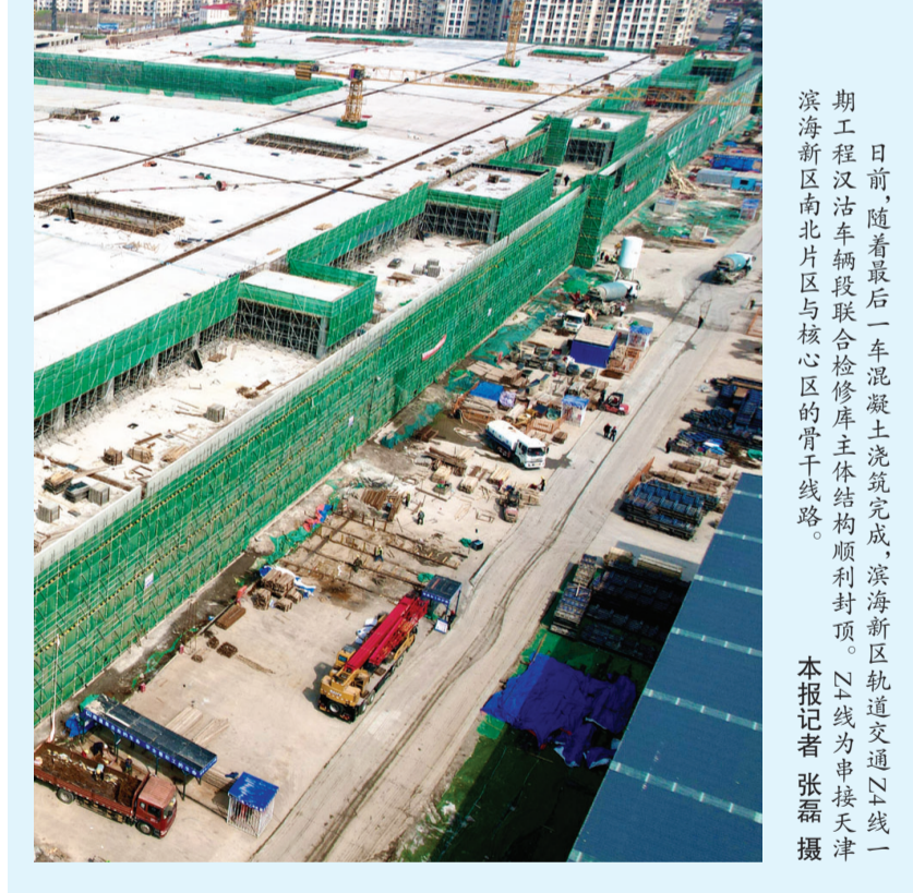
日前,随着最后一车混凝土浇筑完成,滨海新区南北片区与核心区的骨干线路工程汉沽车辆段联合检修库主体结构顺利封顶。N1线为串接天津
