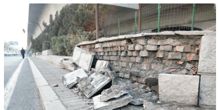
河东区文化馆对面桥下绿化池,多处装饰石砖出现破损。 本报记者 房志勇
