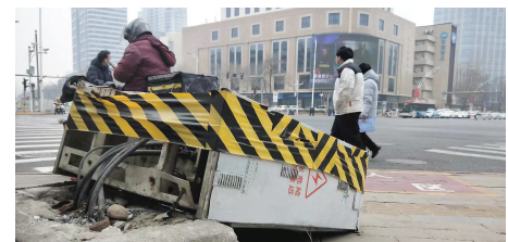
河西区友谊北路服务楼一侧,一通讯电箱损坏倒地。 本报记者 房志勇
