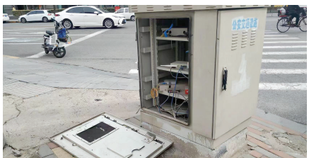
南开区东马路与南城街交口,一个信号灯控制箱门脱落。 本报记者 韩爱青
