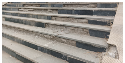
武清区下庄街机场排河桥破损严重。 本报记者 高立红
