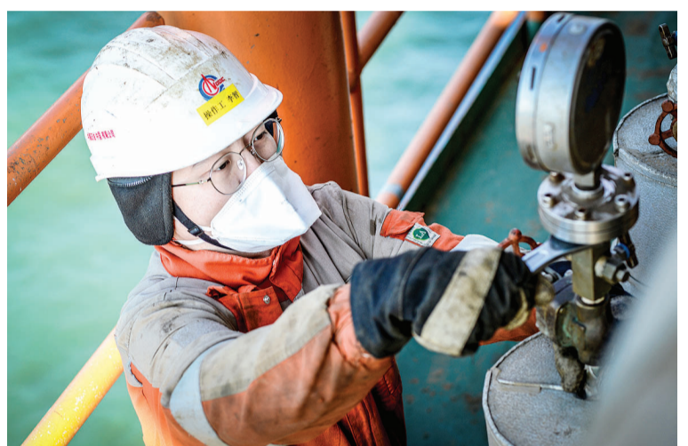
一处压力表故障,现场人员正在更新压力表。
