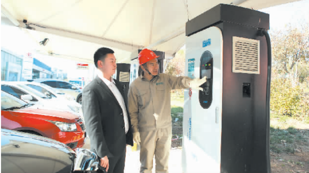
由国家电网投资约3000万元,静海供电有限公司今年初开始在静海城区建设12处电动汽车充电桩,104个充电桩,将于12月底全部完成,预计2017年初投入使用。新能源汽车车主为爱车充电,可以办理充电卡,还可以通过网上进行支付,既方便又快捷,解决了新能源汽车车主的后顾之忧。此项工程,对于新能源汽车的普及将起到积极的促进作用。图为电力工作人员为车主讲解充电桩使用方法。张继芳 刘加平 摄
