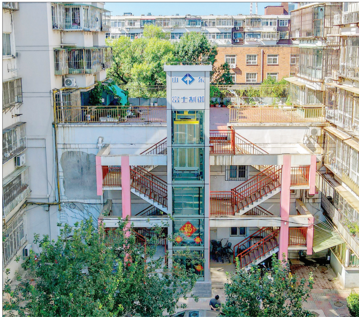
日前，本市河北区鸿顺里街三戒里社区日照公寓小区3号楼5门加装电梯工程完工并投入使用。据了解，该楼位于3层楼高的底商之上，楼内老人居多，回家需要先爬3层楼体外的楼梯才能进入单元楼门，尤其是雨雪天气，楼梯湿滑，给出行带来不便。随着电梯的加装完成，困扰居民的出行问题得到有效解决。新报记者 吴迪 摄
