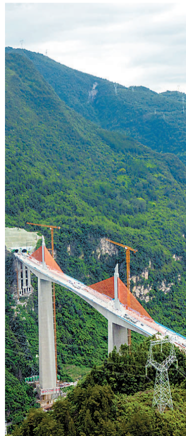
这是位于重庆市彭水县境内的渝湘复线高速磨寨乌江特大桥建设现场。近日，由中国铁建承建的渝湘复线高速关键控制性工程——磨寨乌江特大桥全面进入桥面施工阶段。
